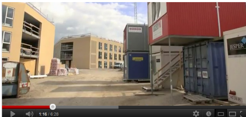
Video viser de nye ungdomsboliger på Ramblaen ved AAU i Aalborg Øst.
